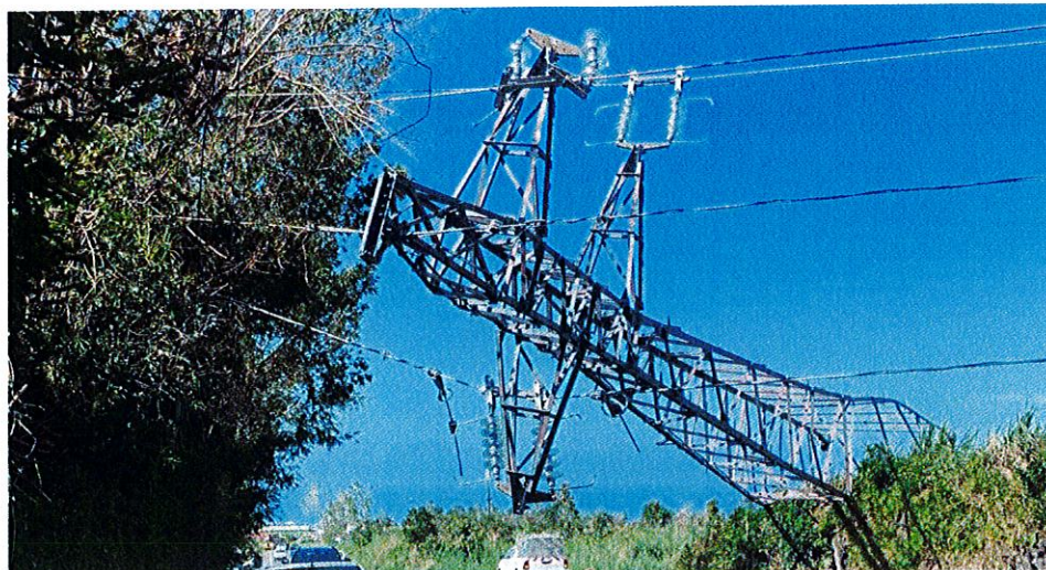
Ligne HTB tombée au-dessus de la RN3 à Saint-Benoît
